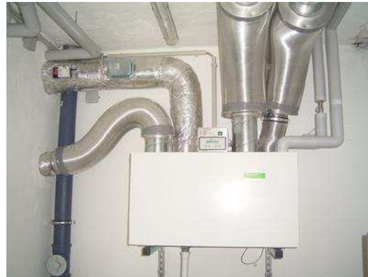
Foto: Bau Info Center Lüftungstechnik
